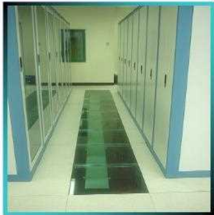
配电系统下走线
